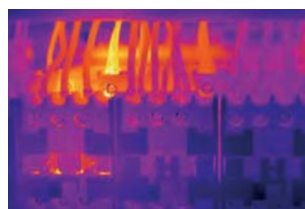
Údržba zařízení: rozpoznání příliš vysokých teplot na pojistkách a elektrických součástkách dříve, než dojde k výpadkům.
