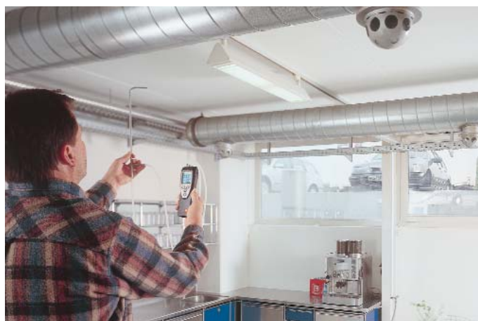
Měření vyfukovaného vzduchu
