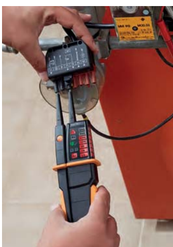
Kontrola napětí na přípojovacím konektoru otopného zařízení pomocí testo 750.
