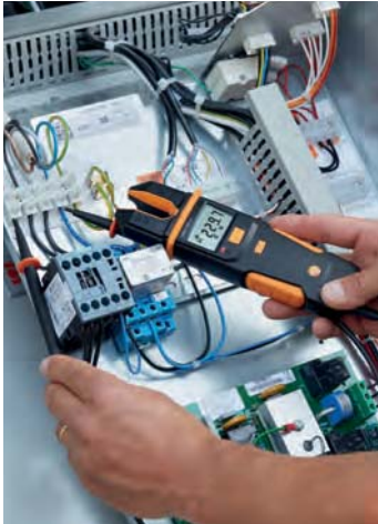
Měření napětí na kompresoru přístrojem testo 755.
