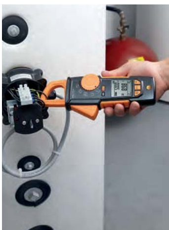
Měření napětí na tepelném zásobníku přístrojem testo 770.
