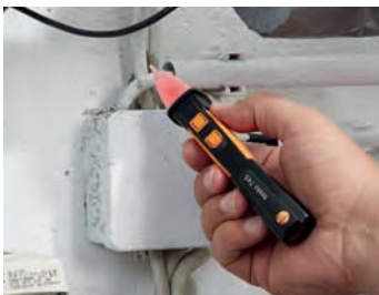
Bezkontaktní zkouška napětí na rozdvojece k vytápěcímu zařízení pomocí testo 745.
