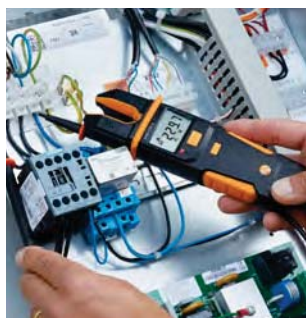
Měření napětí na kompresoru.
