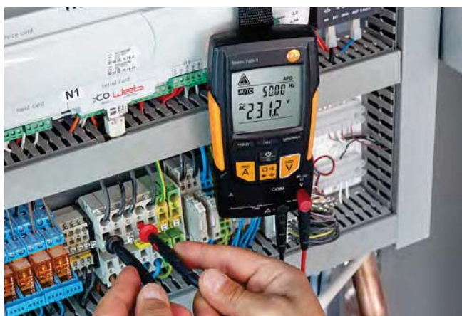
Testování napětí v rozvaděči tepelného čerpadla.
