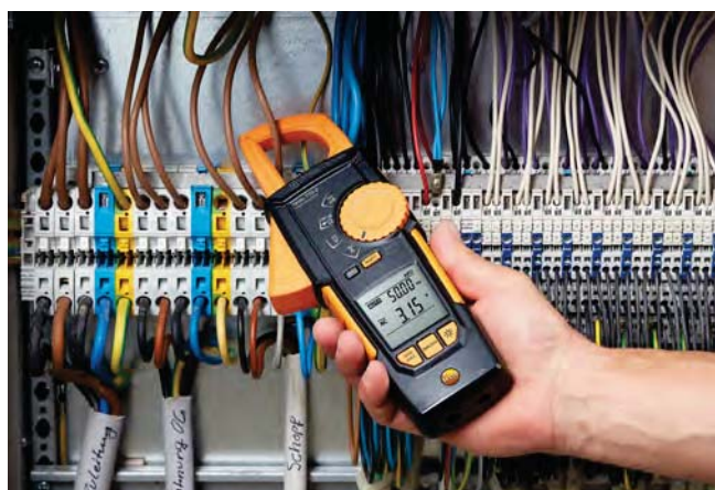
Měření proudu v rozvaděči.
