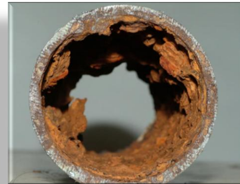
Korozní produkty vytvořené mikroorganismy ve vodě.
